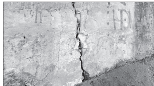
Трещины тела опор
