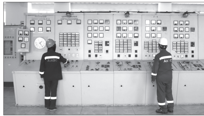
Главный щит управления сегодня
